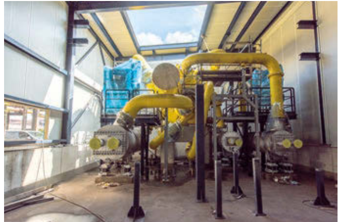
Verdichtergebäude (Verrohrung Verdichter 1)
