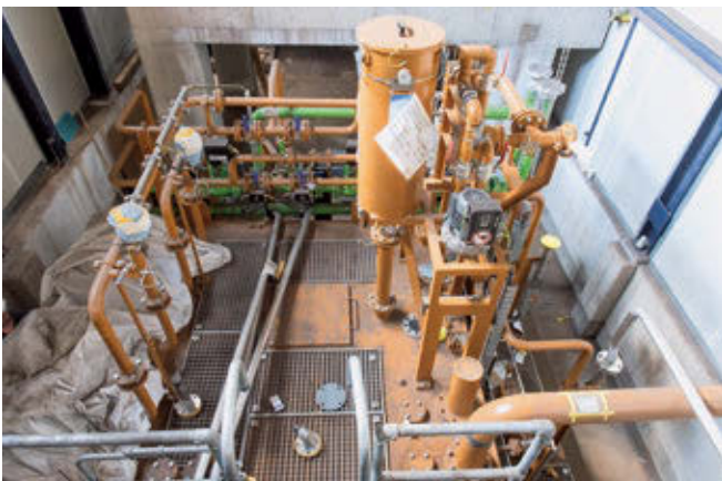
Im Verdichtergebäude ist unter anderem die Ölanlage installiert.
