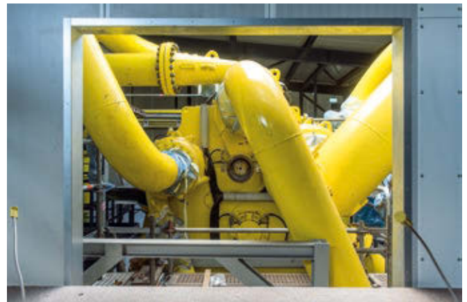
Die Wellendurchführung im Verdichtergebäude mit Blick auf Verdichter 1
