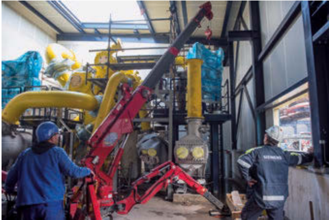
Verdichtergebäude (Verrohrung Verdichter 2)
